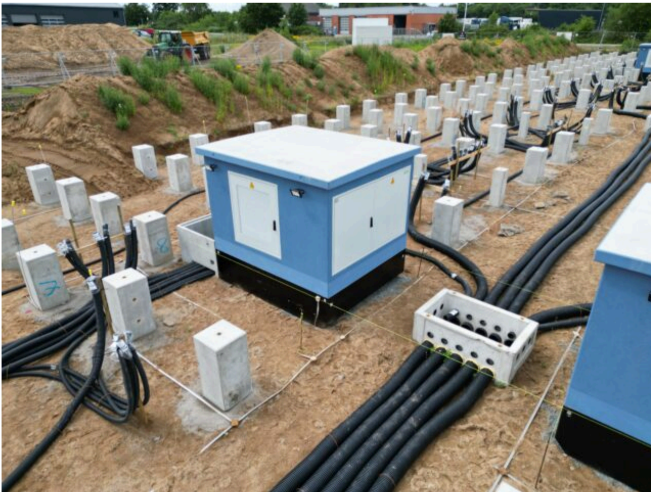
Die Trafostationen stehen bereits in Bollingstedt. Die Container mit den Batterien sollen im Herbst folgen. Foto: ECO STOR
